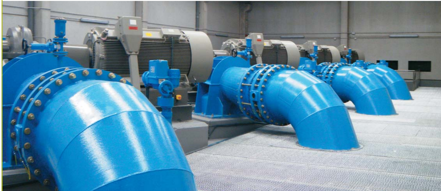
Figura 4: Estació de bombament del sector 3. Font REGSEGA
