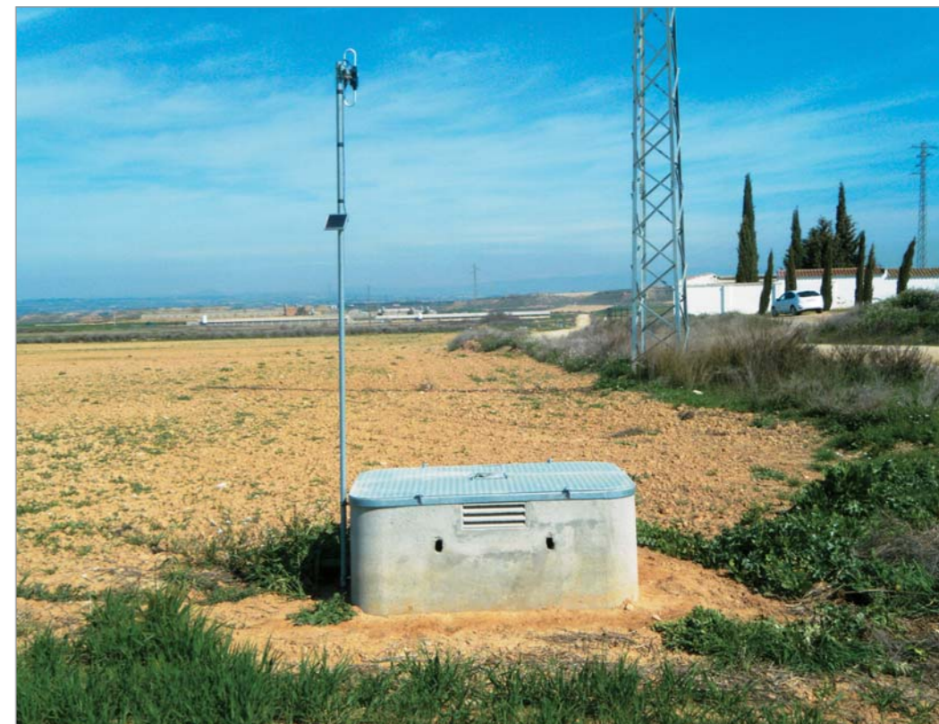
Hidrant amb telecomandament en el sector 12. Font REGSEGA
